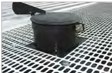
▲ Marmitta residenziale ad alto abbattimento acustico interna al container e griglia espulsione aria calda
