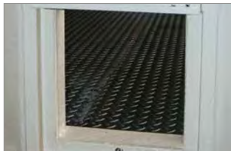
▲ Apertura per ingresso cavi di potenza
