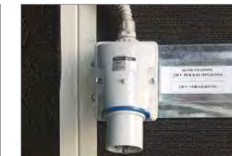
▲ Punto di alimentazione interna 230V
