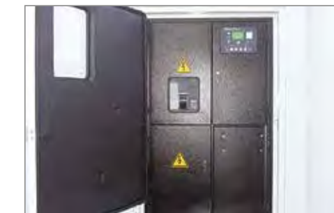
▲ Quadro di distribuzione montato a bordo del gruppo elettrogeno lato lungo
